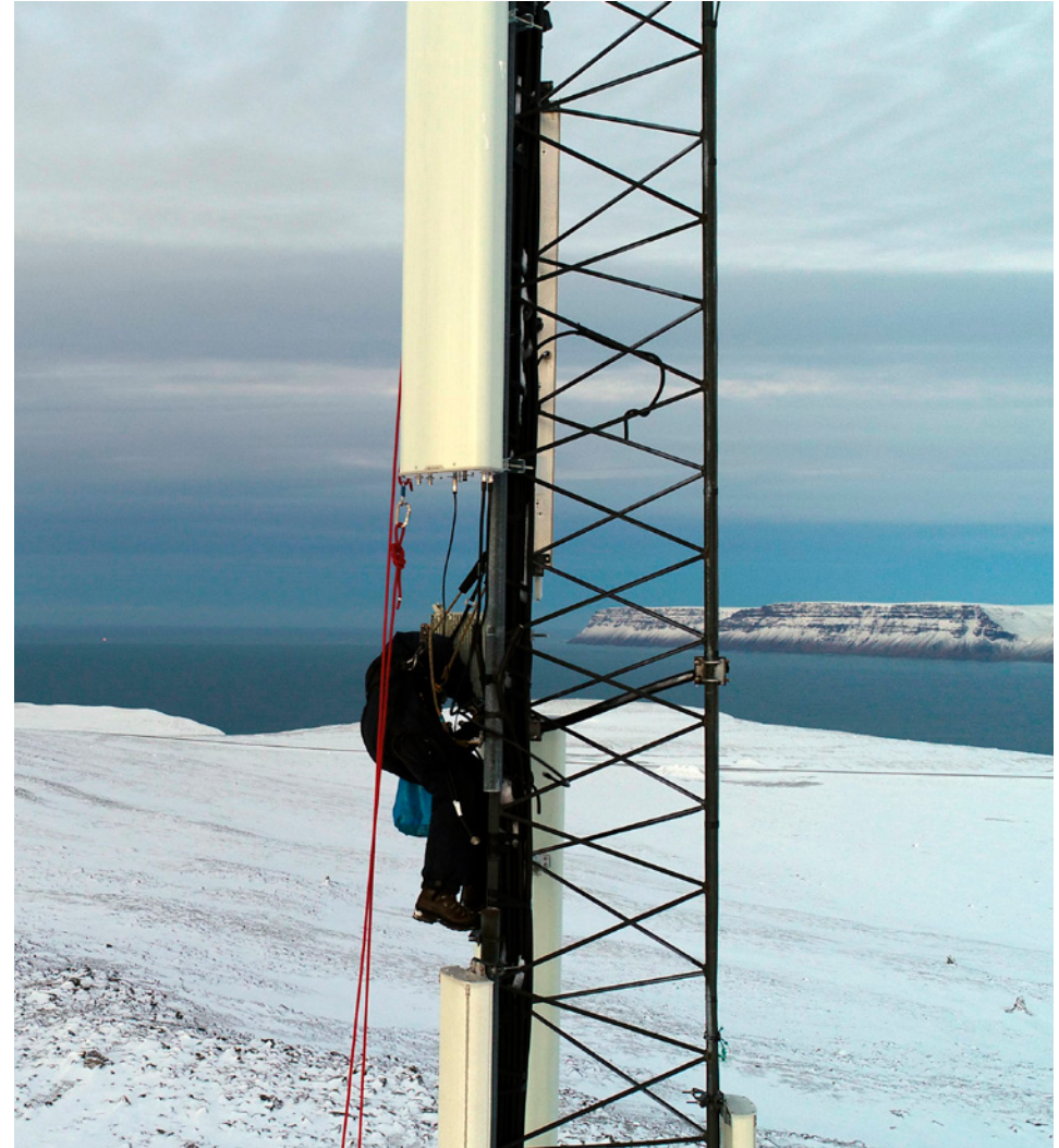
Mastur á Hænuvíkurhálsi (ljósmynd Vodafone)
